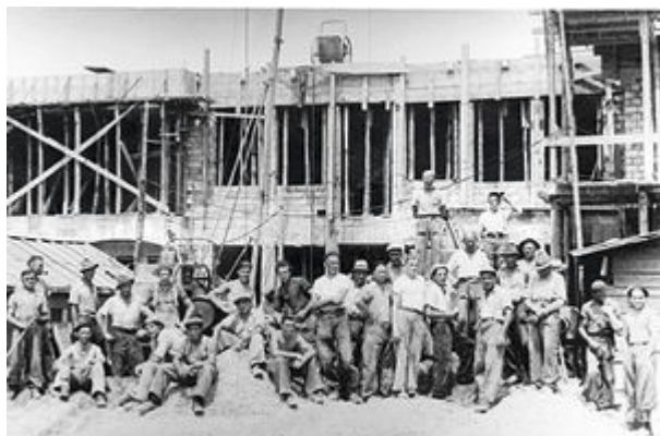
Bau des Schulhauses von Schaan, 1949 (GAS). Heute wird das Gebäude als Rathaus genutzt. Das Bild ist Teil der ersten Baureportage der Gemeinde Schaan.
