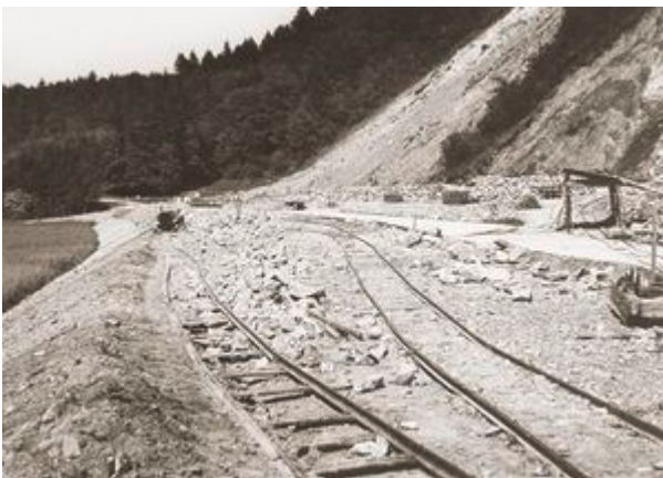
Bau der Strasse vom Steinbruch in Schaan bis zur Nendler Rufe, 1936/37 (LI LA).
